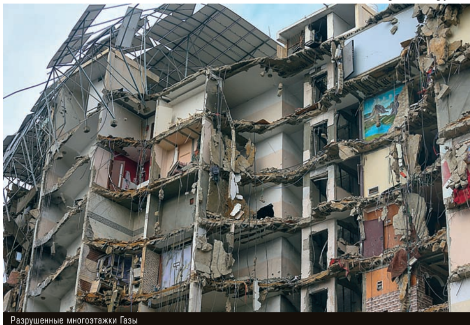
Разрушенные многоэтажки Газы
